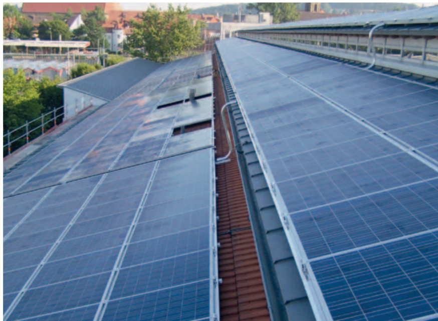
PV-Anlage auf dem Werkstattdach der Stadtwerke
