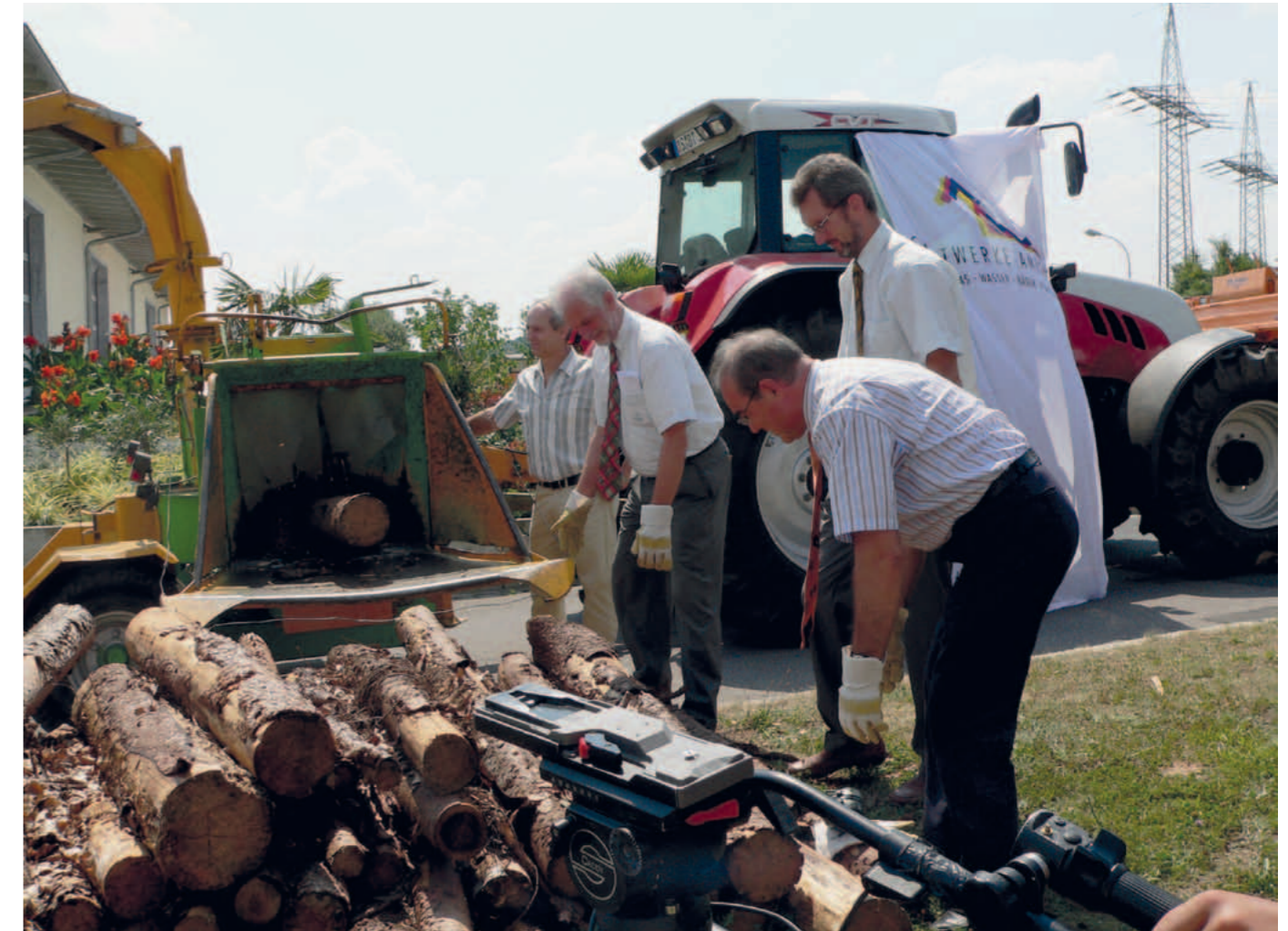
Imbetriebnahme Hackschnitzelheizung Betriebshof Stadt Amberg, 2006
