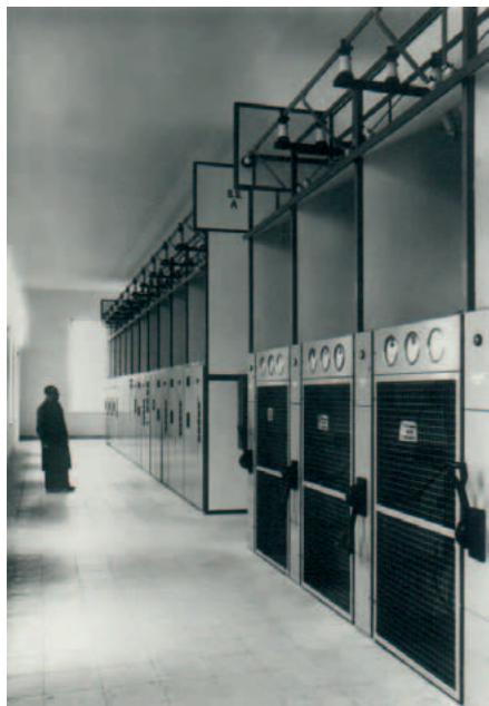
Umspannwerk Am Anschuss, 60er-Jahre
